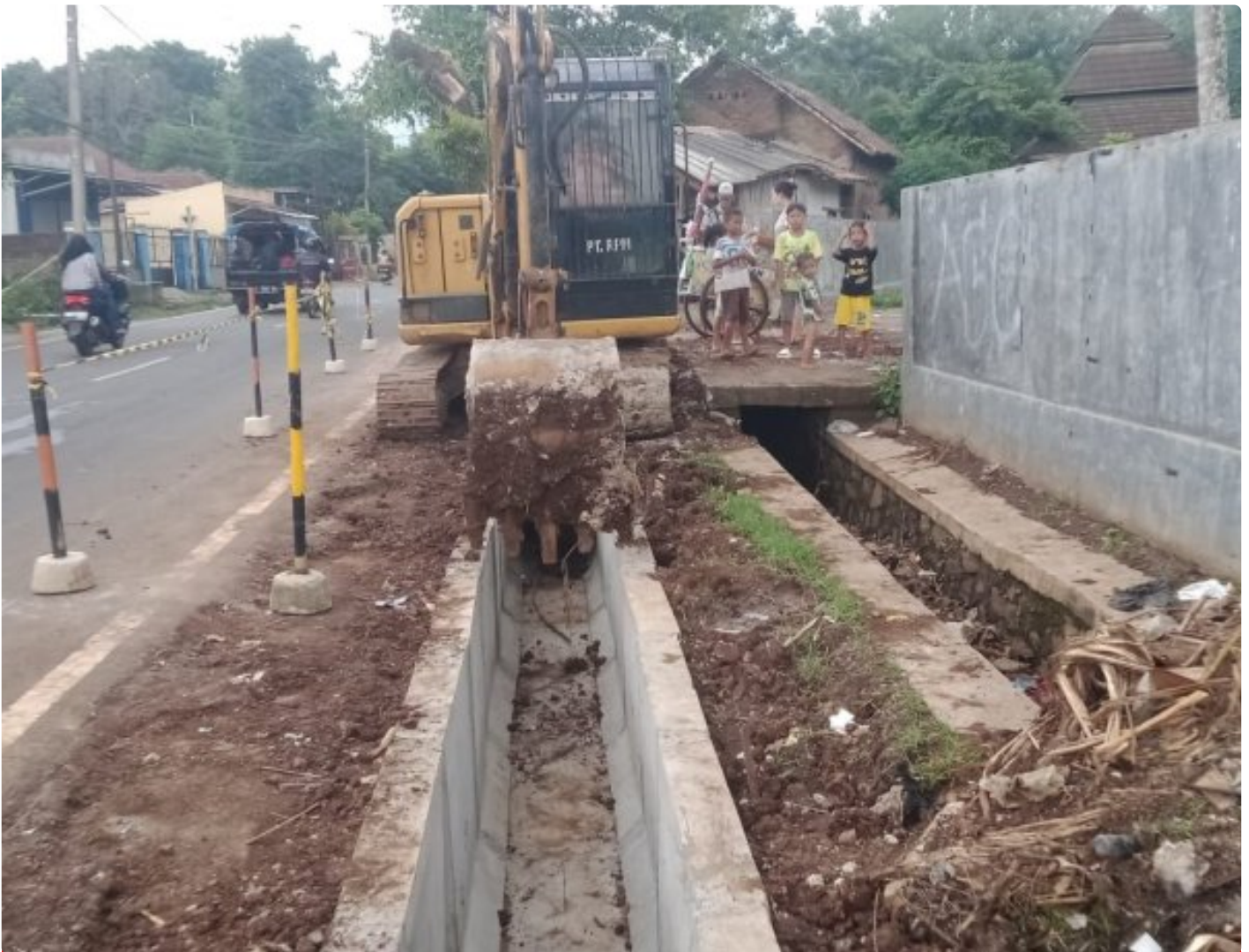
Proyek Drainase Jalan Pandeglang - Labuan Diduga Tak Sesuai Spesifikasi Kontruksi
